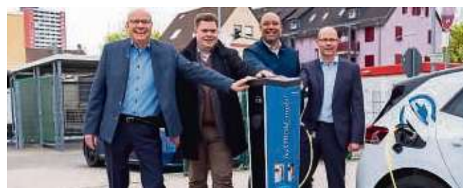
Seite an Seite beim Ausbau der E-Ladeinfrastruktur: Stadtwerke-Chef Kirk Reineke (von links), Erster Stadtrat Stefan Schmitt, Vernon Chaney und Daniel Tomazic (beide Arrow) nehmen die Säule offiziell in Betrieb.
